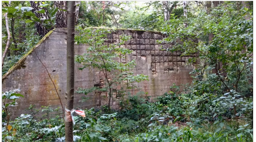
Die Betonwanne von der Seite. Bei einem Versuch, der positiv verlief, wurde so große Hitze frei, dass Teile von der Wand abplatzten, als der eigentliche Reaktor durch einen Kran herausgehoben wurde.
